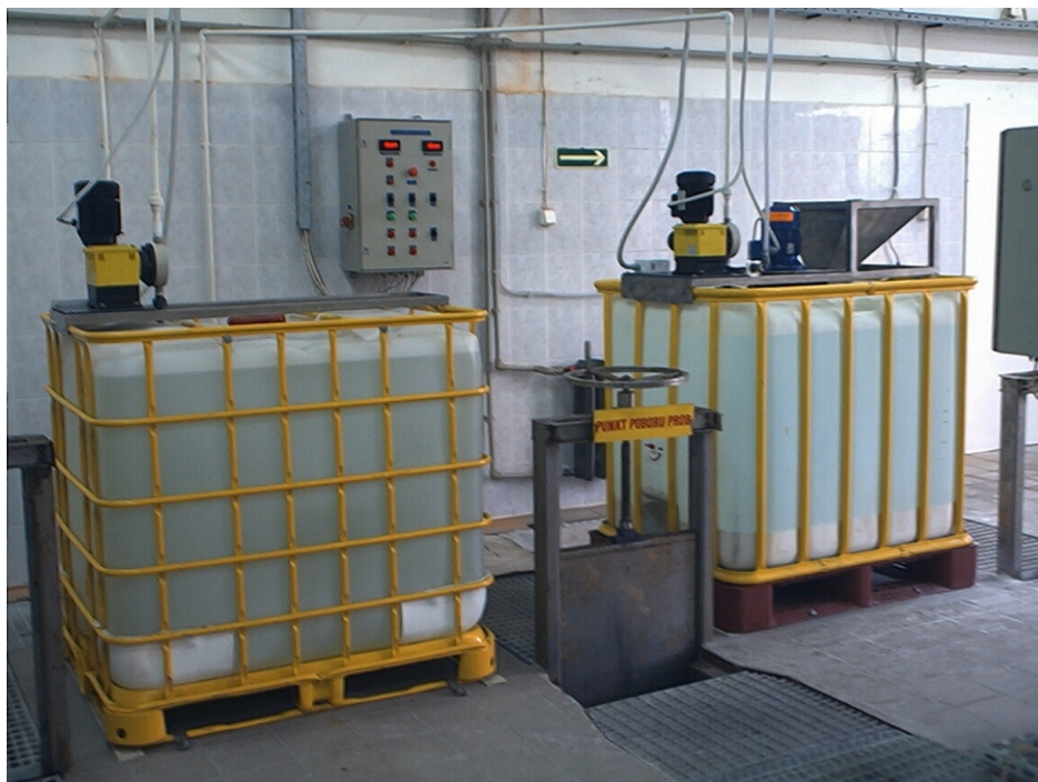
WIDOK STACJI KOREKCJI pH
