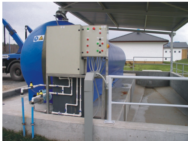
STACJA MAGAZYNOWANIA I DOZOWANIA PIX
