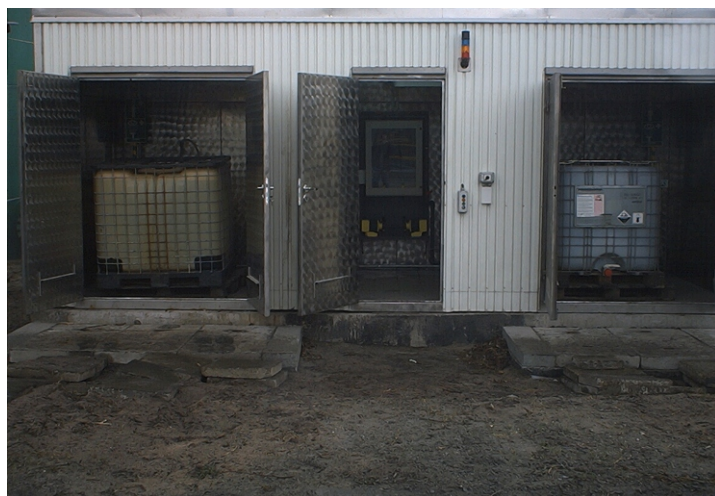
WIDOK KONTENEROWEJ STACJI WYTWARZANIA ClO 2
