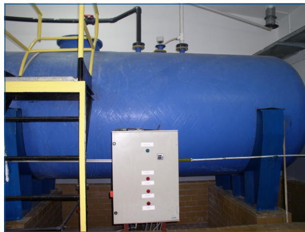
Zbiornik magazynowy chlorynu
