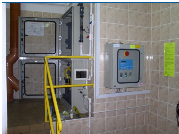
Widok generatora ClO_2
