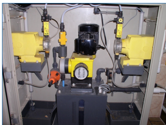
Komora dozowania generatora
