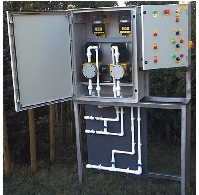
WIDOK STANOWISKA POMP DOZUJĄCYCH STACJI DOZOWANIA PIX
