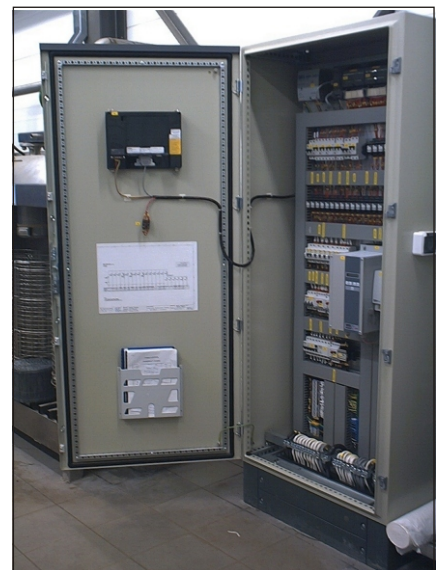
WIDOK SZAFY STEROWNICZEJ OCZYSZCZALNI I FLOTOTORA
