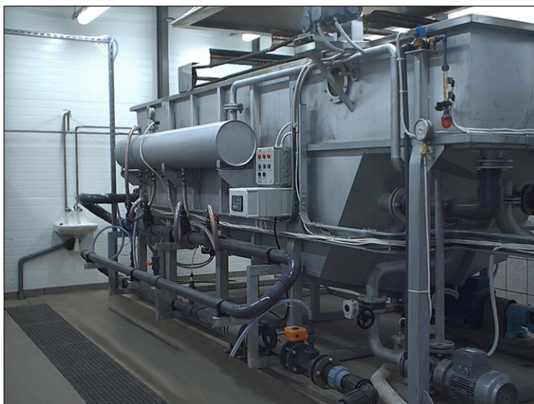
WIDOK FLOTATORA OCZYSZCZALNI
