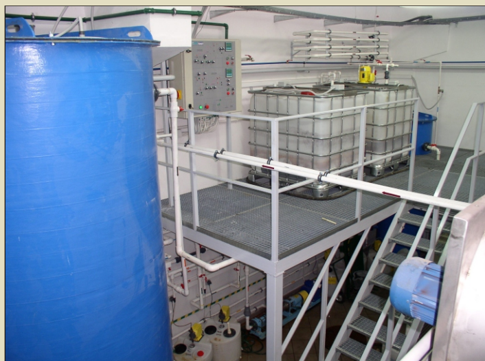
Widok podczyszczalni ścieków
