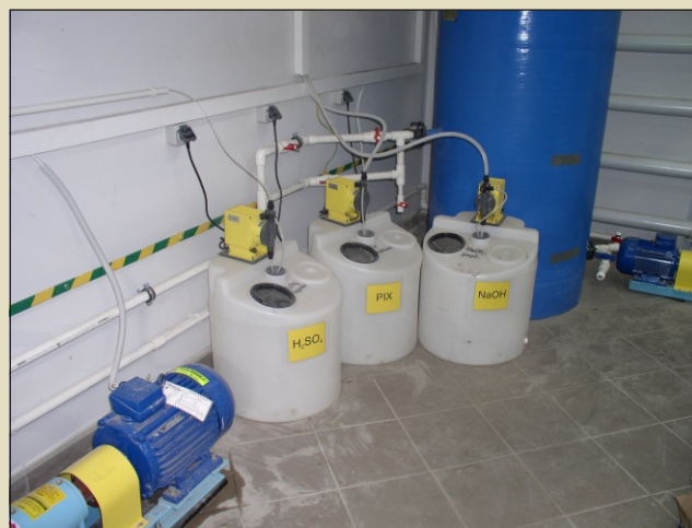
Stacja dozowania chemikaliów podczyszczalni ścieków
