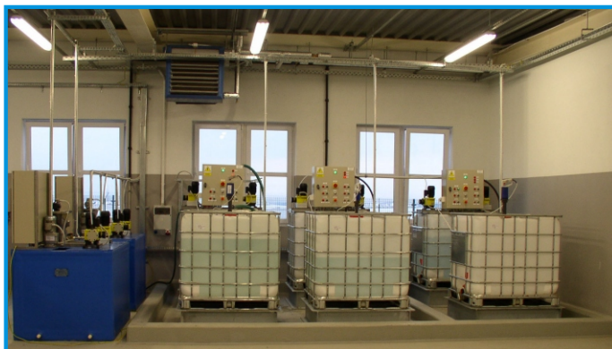
Stacja przygotowania i dozowania chemikaliów
