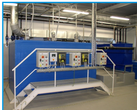
Reaktor obróbki ścieków, mierniki-regulatory pH
